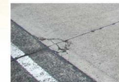
隅角部ひびわれ
